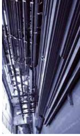
Instalaciones SALTER en Barcelona (España)
